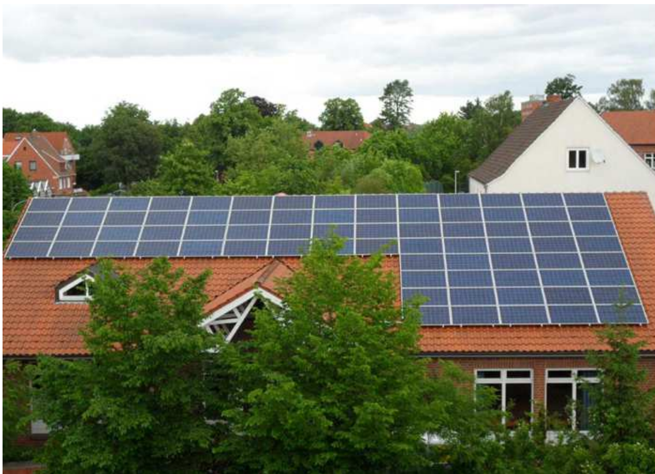
Abbildung: Fotovoltaikanlage Gemeindehaus
